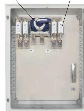
DC出力開閉器 DC入力ヒューズ端子台
