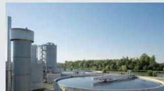
水処理プラント
