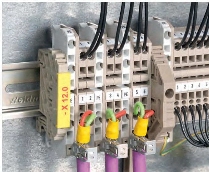
árnyékolás rögzítése a funkcionális földeléshez
