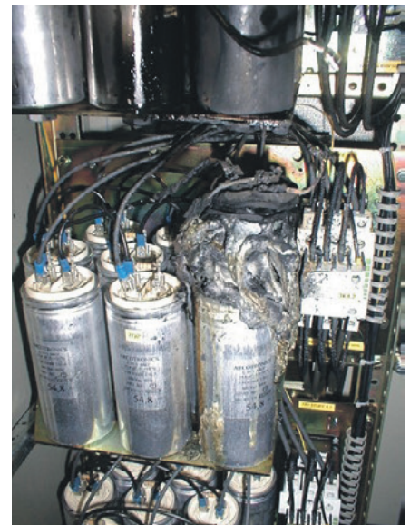
Abb.: Zerstörte Kondensatoren durch Oberschwingungen
