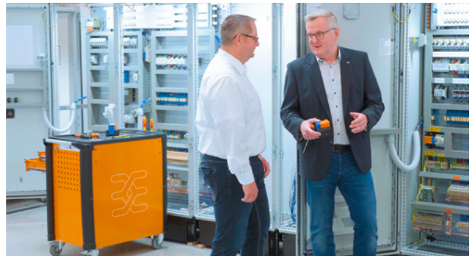
Dirk Späte, Teamleiter Schaltschrankbau Produktion bei Bosch Building Automation GmbH, und Ralf Dolle, Vertriebsingenieur bei Weidmüller, sind gleichermaßen begeistert von der Zuverlässigkeit der VARITECTOR AC Line.
